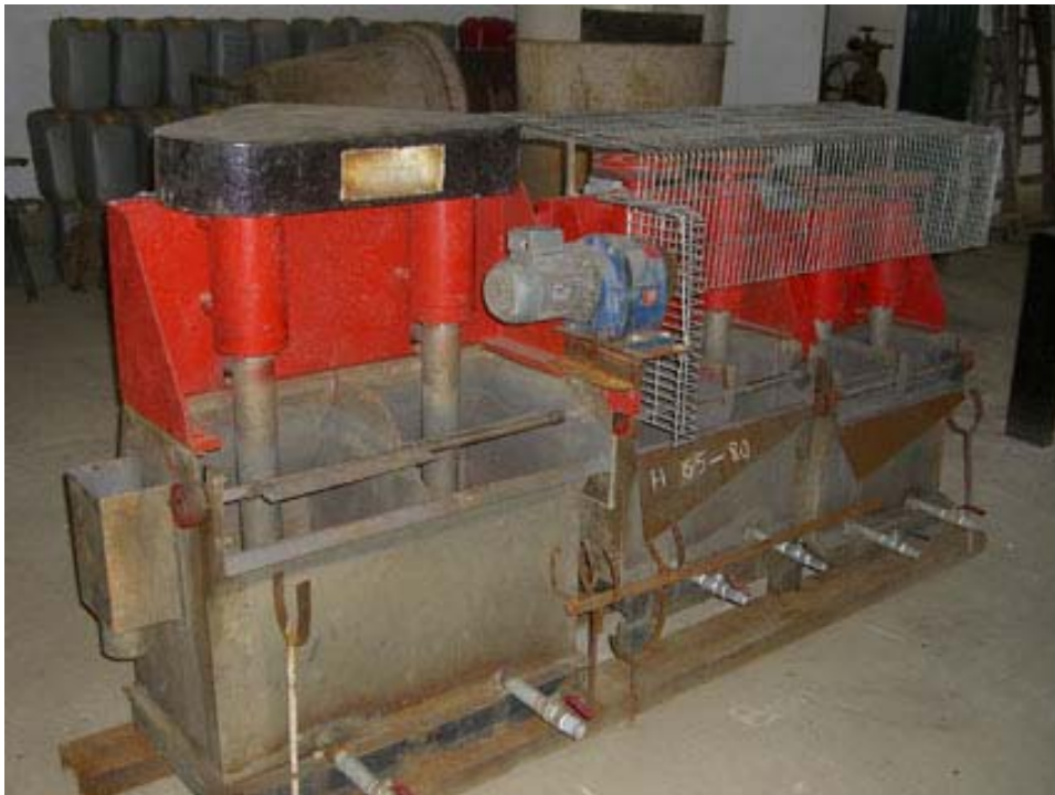
Celdas de flotación
